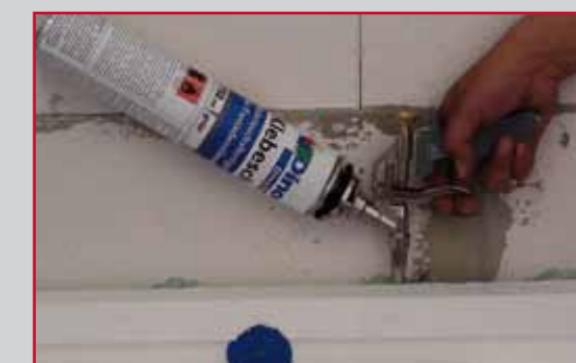
Die mit dem StellmaXX-Dübel fixierte Platte wird mit Schaum aus der Klebepistole verklebt. Mit der 60 cm langen Lanze erreicht man die ganze Fläche
